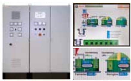
Schaltschrank und Leittechnik mit Visualisierung
